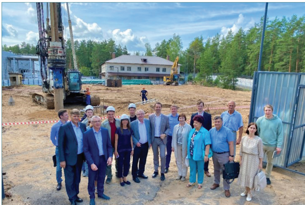
27 июля 2023 г. Вбита первая свая на строительном участке экспериментального корпуса циклотрона У-400Р
