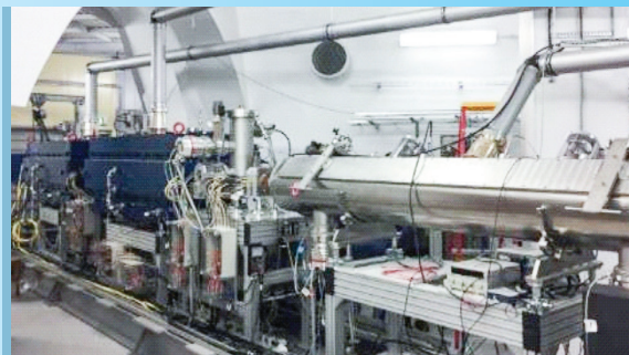
Ввод в эксплуатацию HILac
