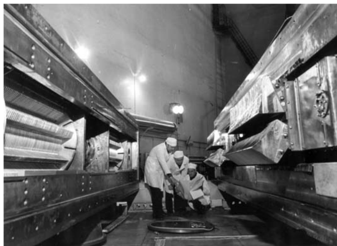
Рис. 3. Вариатор в процессе монтажа: слева — роторы вариатора в корпусе, справа — статорные (дуантные) пакеты
